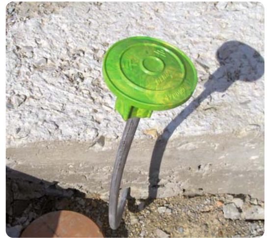
Schutzkappe auf Anschlussfahne
