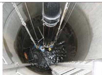
Szivattyúakna kettő szivattyúval
