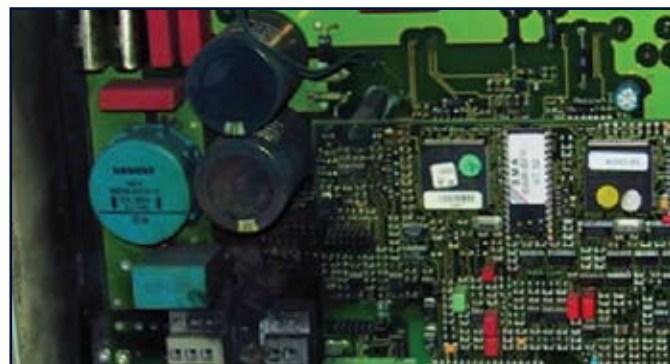
4. ábra: invertermodul roncsolódása túlfeszültség-impulzus hatására
