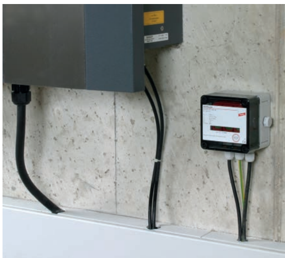
16. ábra 2. típusú túlfeszültség-korlátozó, DEHncube YPV SCI 1000 1M, inverterek védelmére
