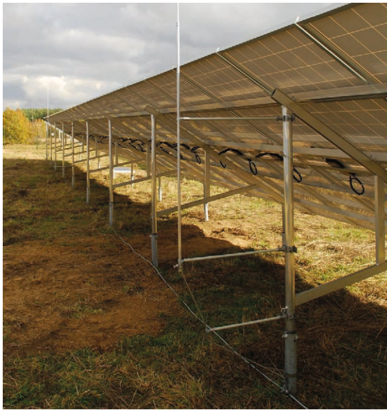
Bild 2 Blitzschutz mit DEHNiso-Befestigungshalter
